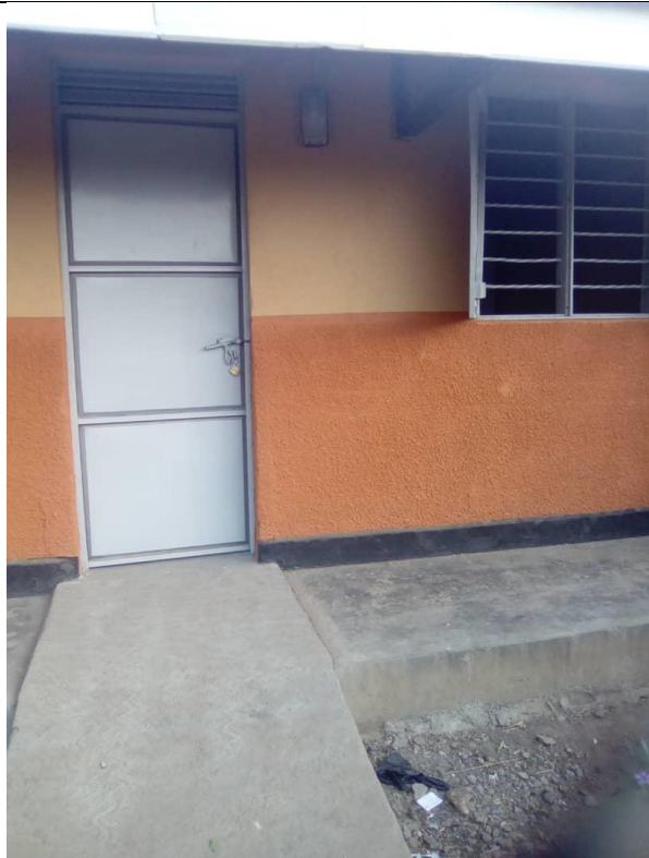
Bild 12: Instandgesetzte Tür vom Direktorat
